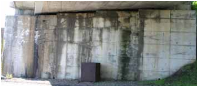
写真－1 橋台豎壁のひび割れ状況
