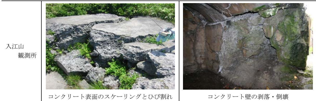
写真-6 入江山観測所跡地の主要損傷
