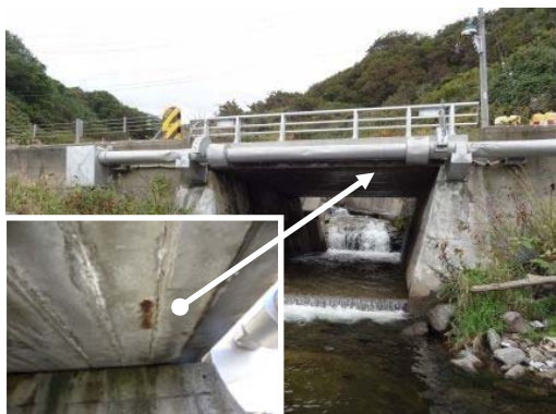
写真-1 PC床版橋の海側側面と桁下の錆汁
